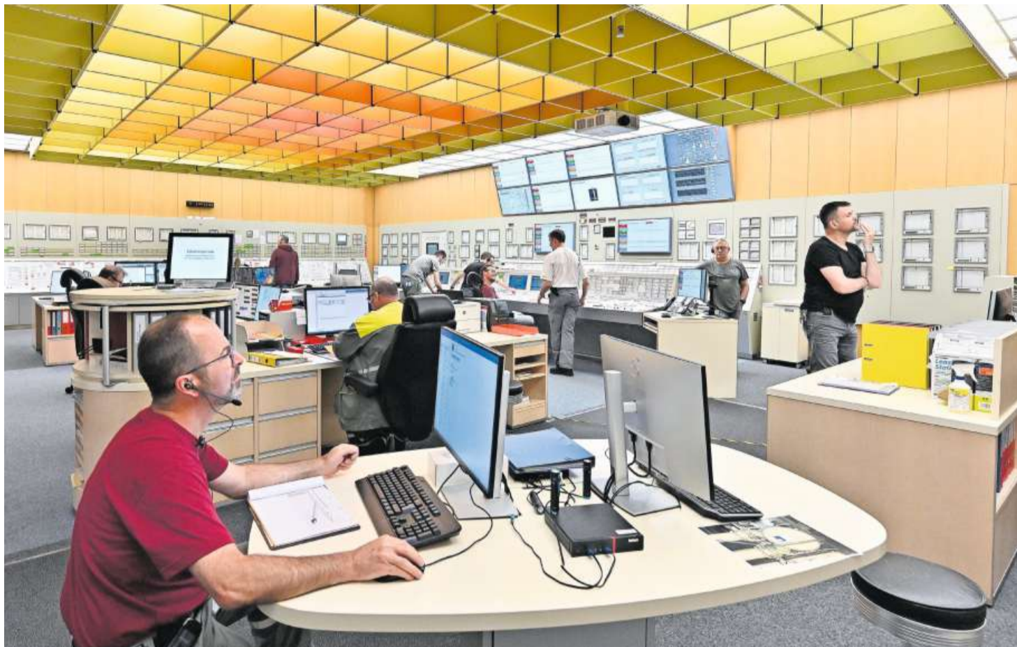
Der Kommandoraum: In diesen Tagen wird der Reaktor im Kernkraftwerk Gösgen wieder hochgefahren.
