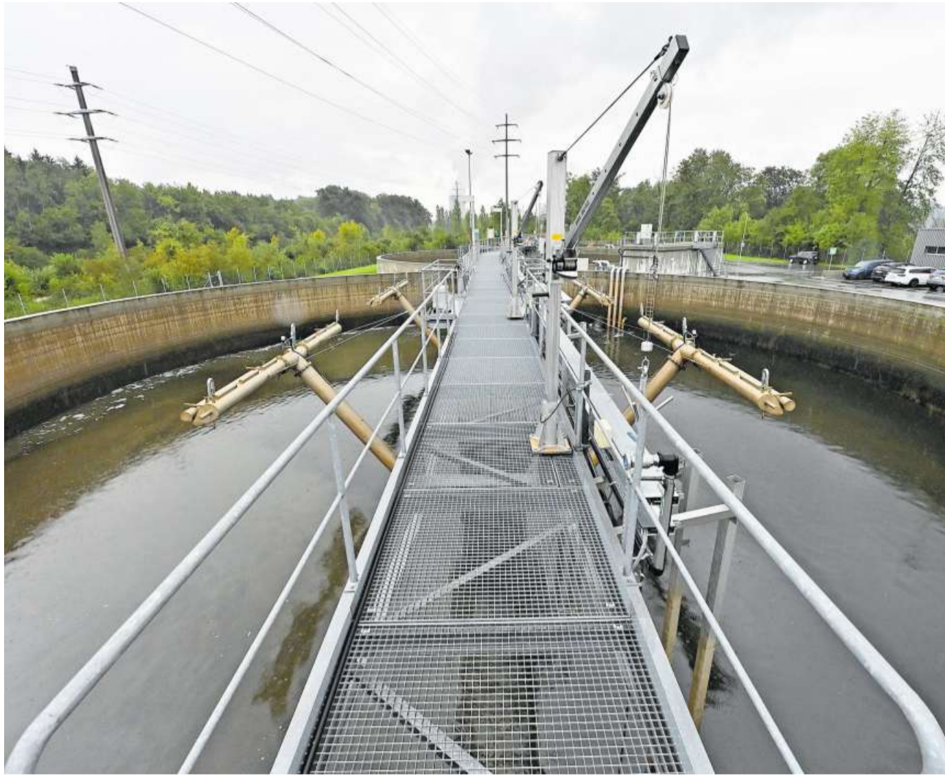
Neue Anlagen und IT-Systeme: Die ARA Winznau trifft wegen der Trinkwasserverschmutzung von 2018 keine Schuld. Bild: Bruno Kissling
