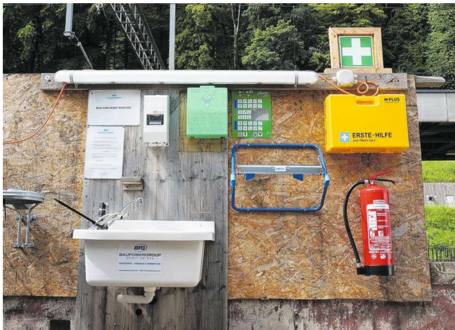
Installation auf dem Bauzug vor dem Portal in Tecknau: Bald starten die SBB – rund acht Monate später als geplant – mit dem Grossprojekt im Hauenstein-Basistunnel. Bilder: Noël Binetti
